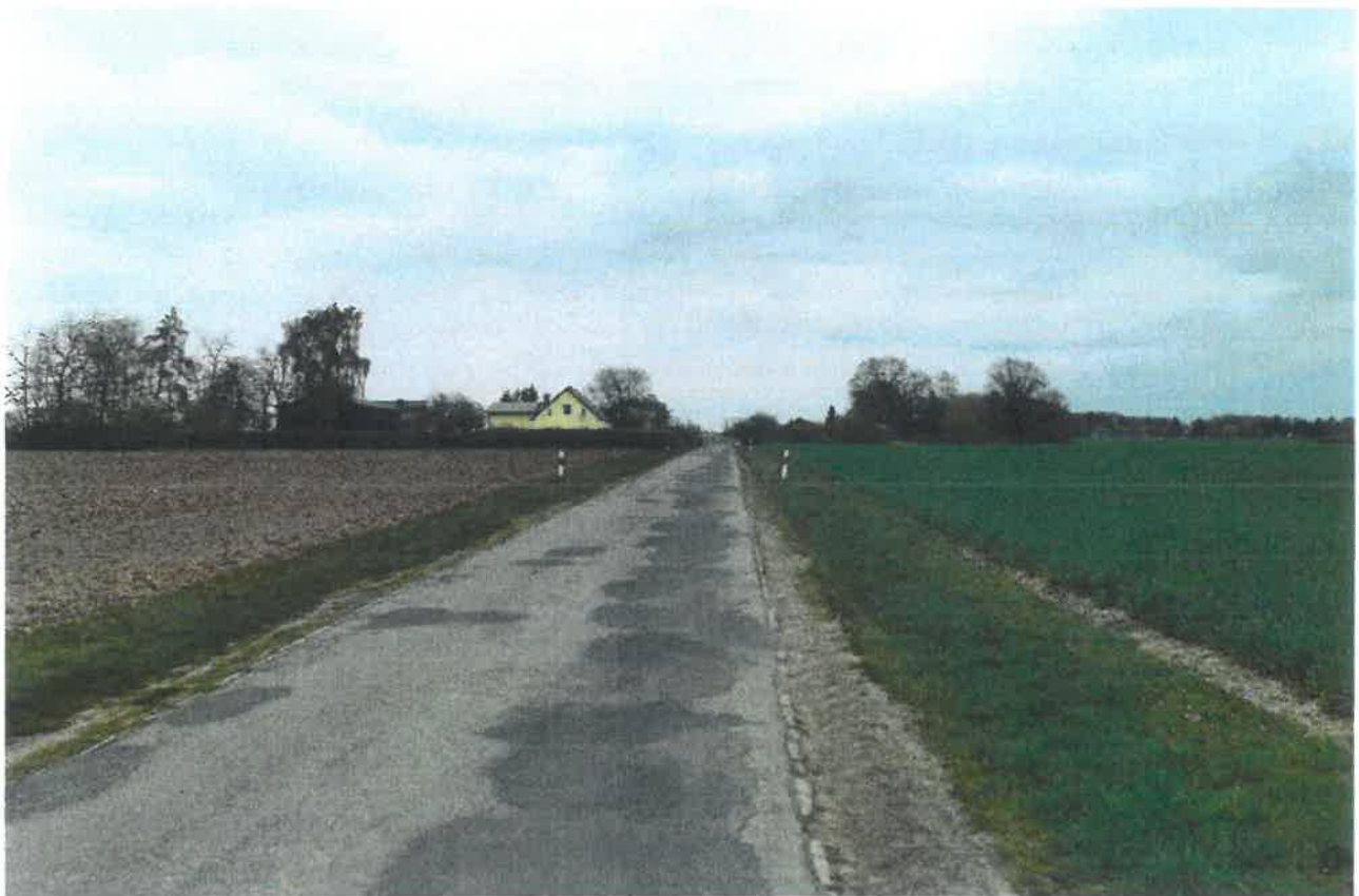
Foto 5: Gleicher Standort wie bei Foto 4 mit Blick in Richtung Pamitz. Der Seitenstreifen wird teilweise mitbefahren und die Fahrbahn wurde mehrmals geflickt.
