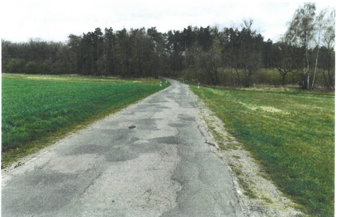
Foto 4: Rückblick in Richtung B 109. Auch hier sind Flickungen sowie Risse und Ausbrüche im Asphalt erkennbar.
