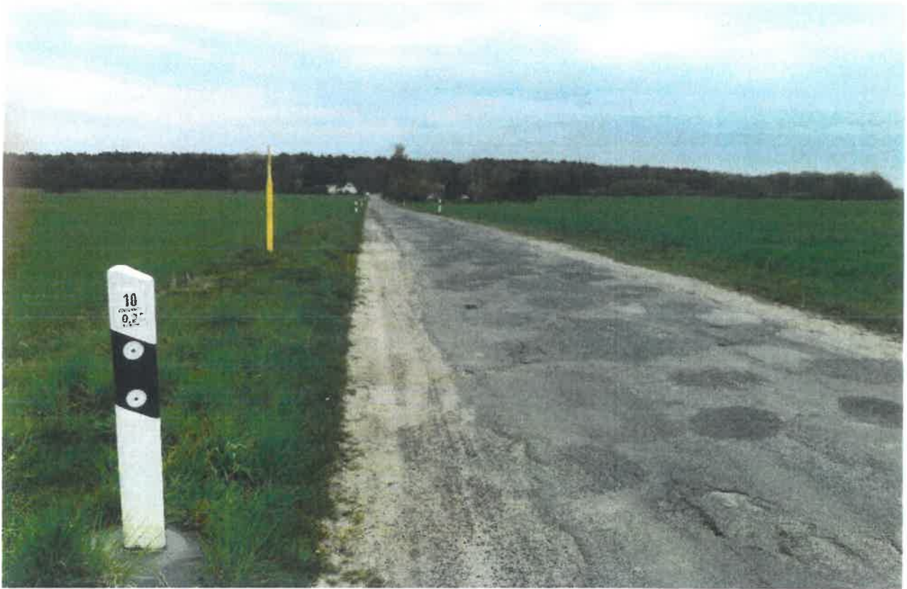
Foto 1: Bei Kilometer 0,2 sind Ausbrüche sowie mehrmalige Flickungen erkennbar.
