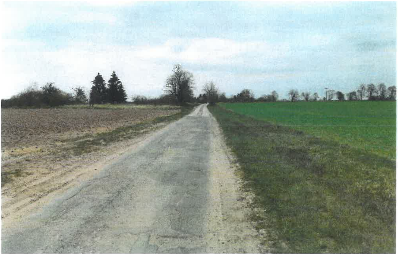
Foto 9: Am Ende der asphaltierten Strecke sind Ausmagerungen sowie lokale Ausbesserungen und Flickungen erkennbar.
