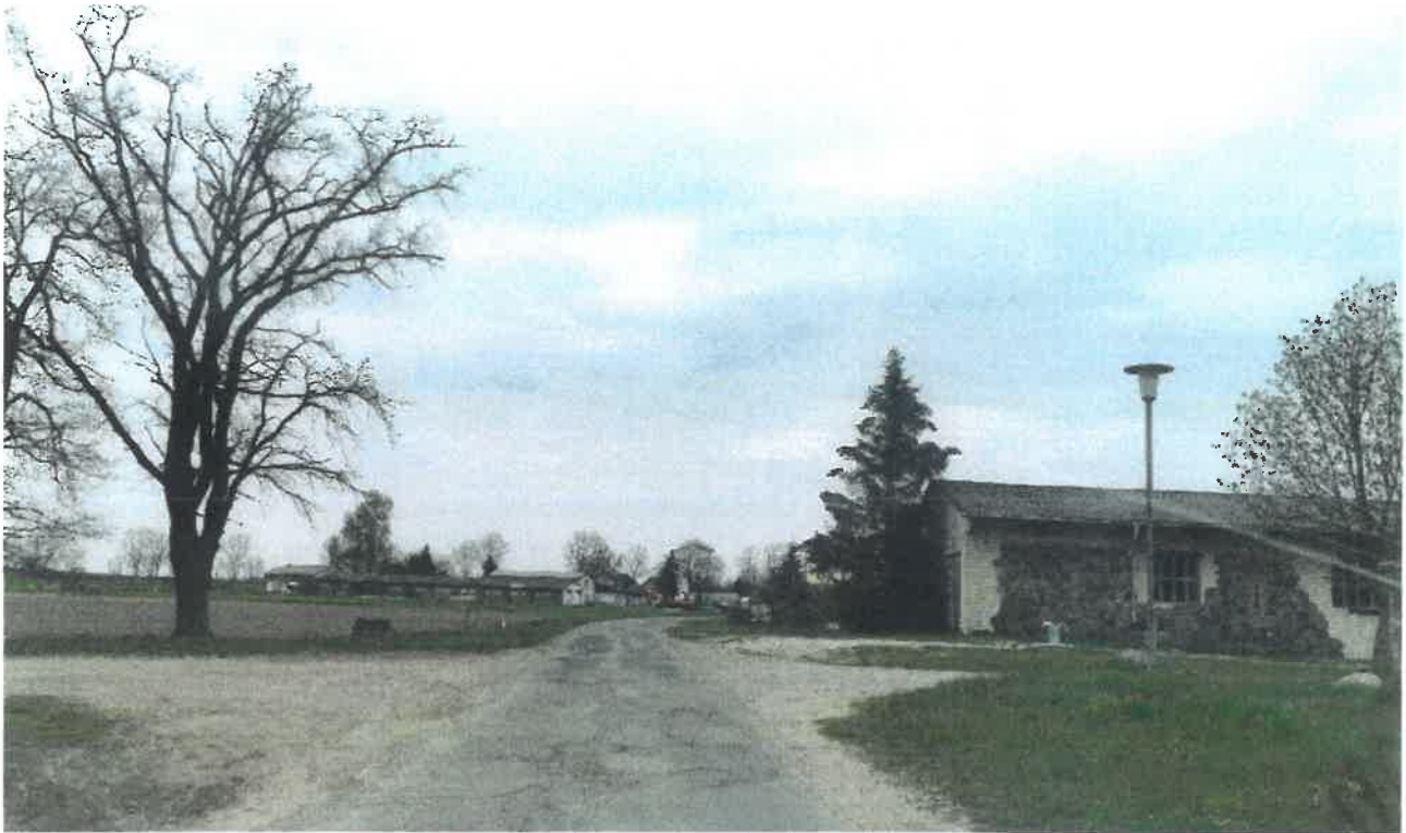
Foto 7: Rückblick in Richtung Ortseingang: Deutlich sind auch hier die Flickungen erkennbar.
