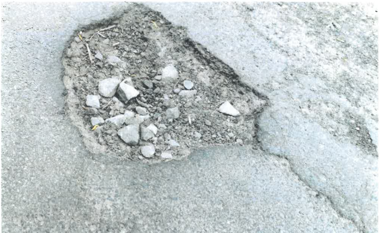
Foto 8: Vereinzelt sind Schlaglöcher vorhanden. Hier ist der Schotter aus dem ungebundenen Oberbau erkennbar. Die Asphaltdecke ist sehr dünn.
